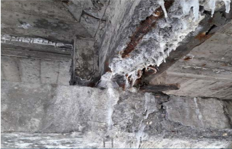
Обследование: обильные протечки через стыки с разрушением ребер плит и опорных стоек
